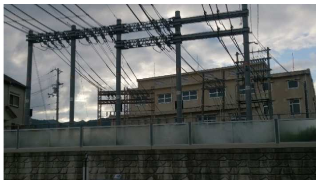
3 引込線に沿って現在も送電線が生きている (現 JR 芦屋変電所)
